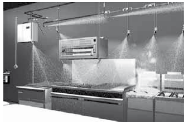
Abb. 1 Beispiel einer Kleinlöschanlage über einer Frittiereinrichtung
